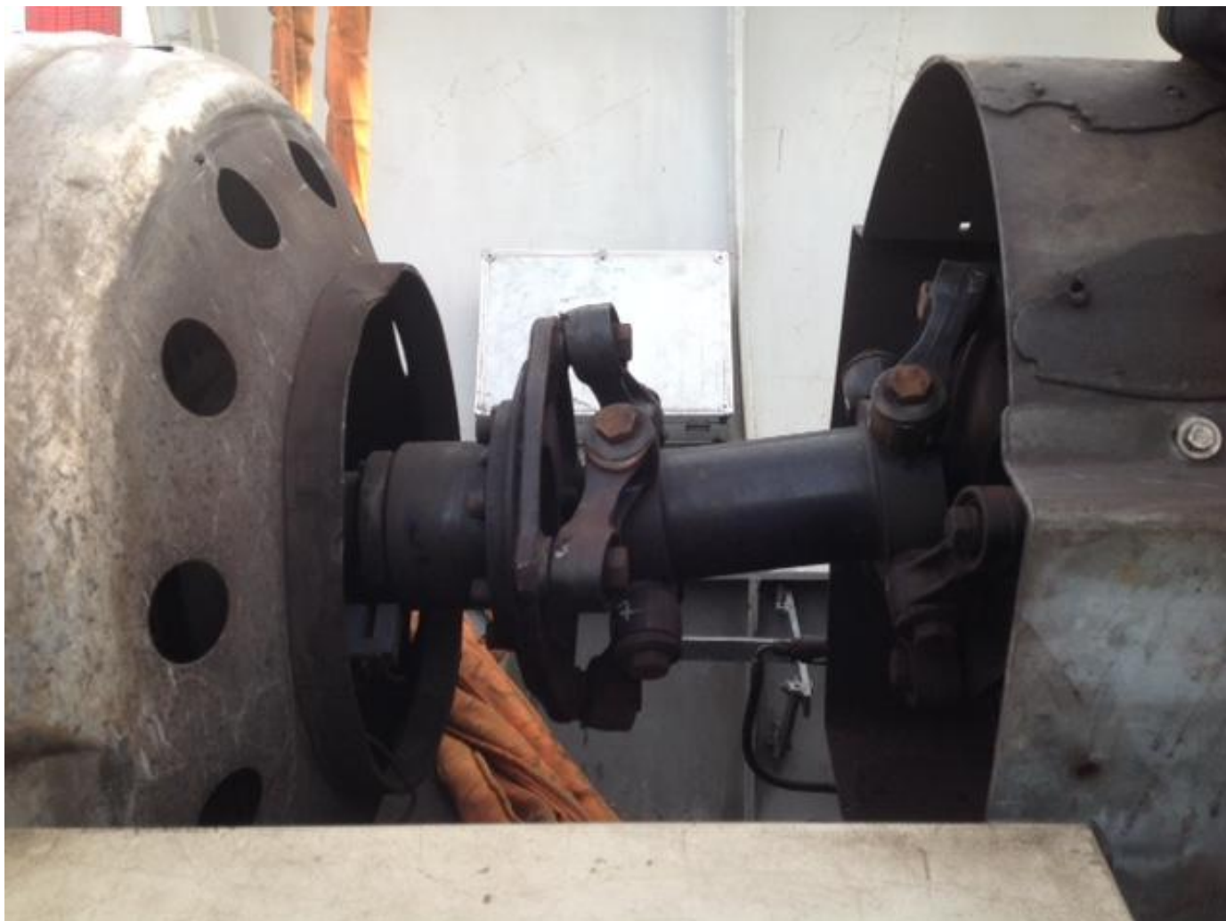
Figur 1: Mølle 6 Generator hænger i kobling pga. knækkede gevindstænger.
